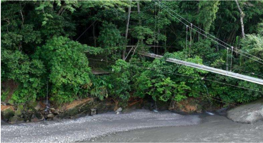
Paso elevado Cafarnaúm torre margen derecha en riesgo de colapso socavación a menos de 2 metros
