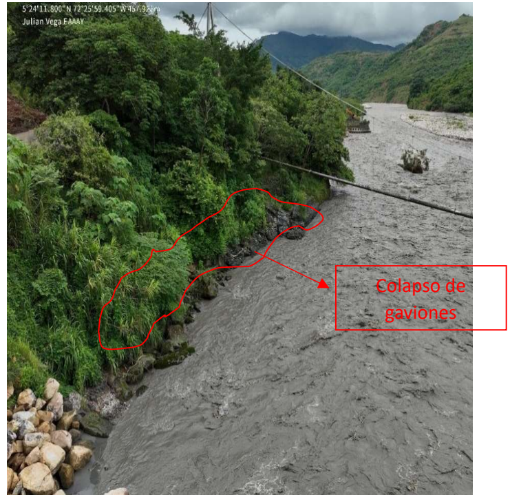
Colapso gaviones en Paso Elevado El Viejo
