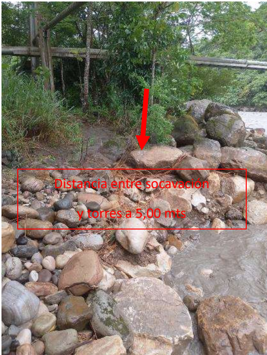
Socavación margen izquierda Cafarnaúm
