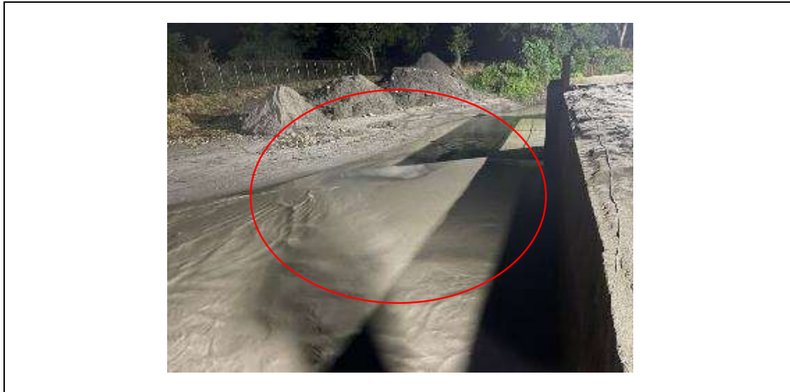
Ilustración 24 Material acumulado en bocatoma
