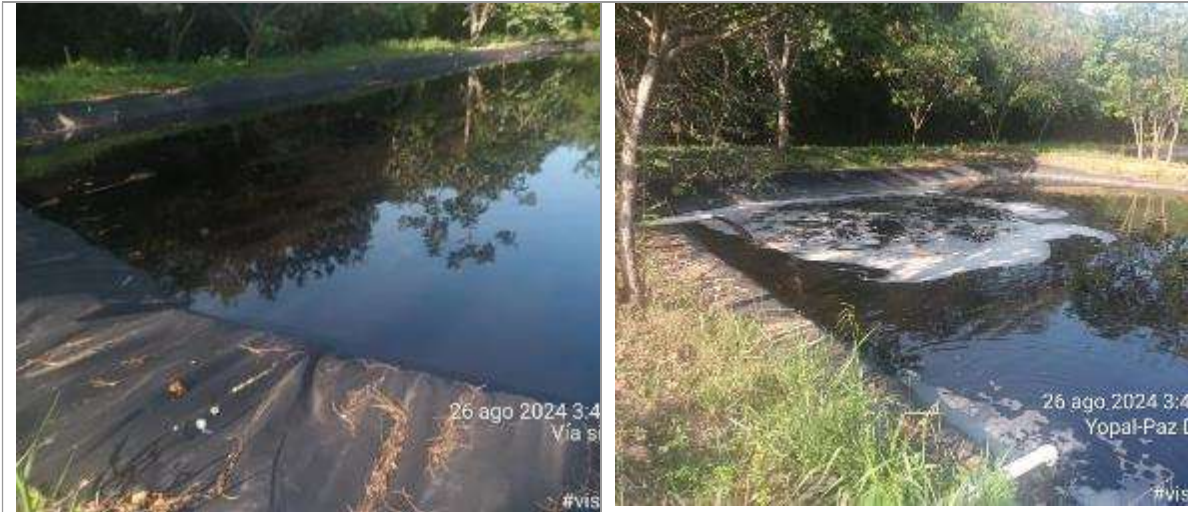
Ilustración 50 Estado actual piscinas Fase 1
