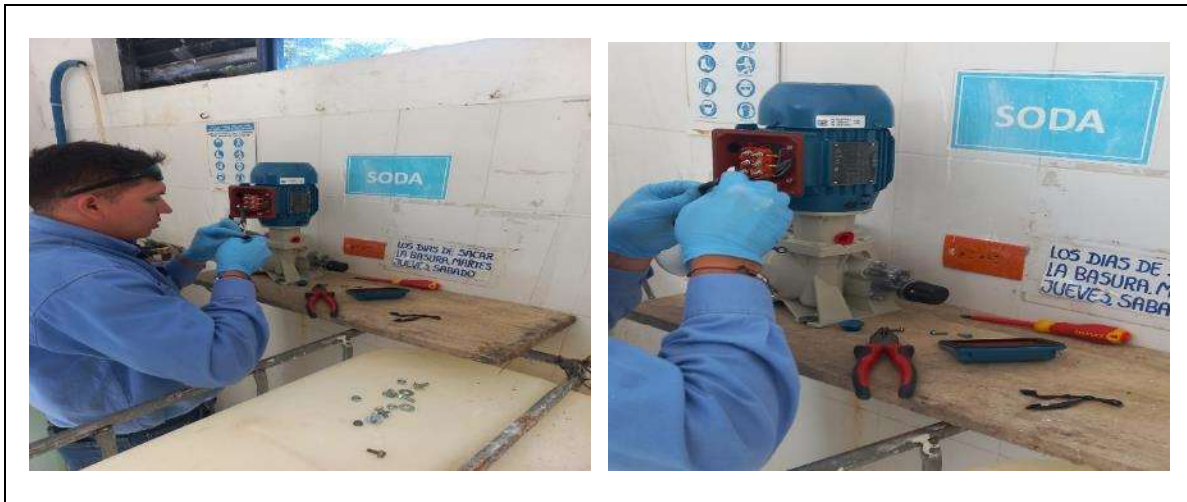
Ilustración 32 Instalación de bomba dosificadora de hipoclorito de calcio en el Pozo Manga de Coleo
