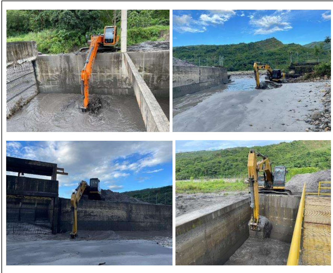
Ilustración 12 Mantenimientos realizados en el mes de mayo/2024 con máquina retroexcavadora para la extracción de material En la Tabla 18, se presenta las fechas de los mantenimientos realizados con la máquina retroexcavadora en la bocatoma para la extracción de material sedimentado.
