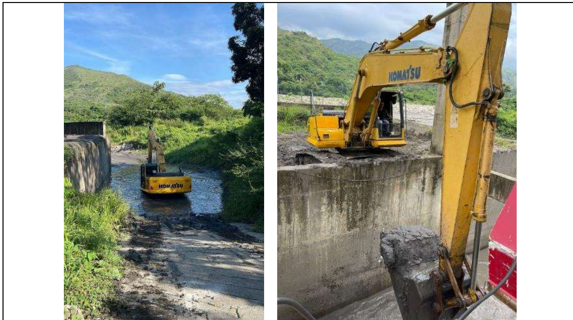
Ilustración 10 Mantenimientos realizados en el mes de mayo/2024 con máquina retroexcavadora para la extracción de material A continuación, se presenta la sedimentación de material en la bocatoma y las actividades de mantenimiento realizadas en el mes de junio/2024.
