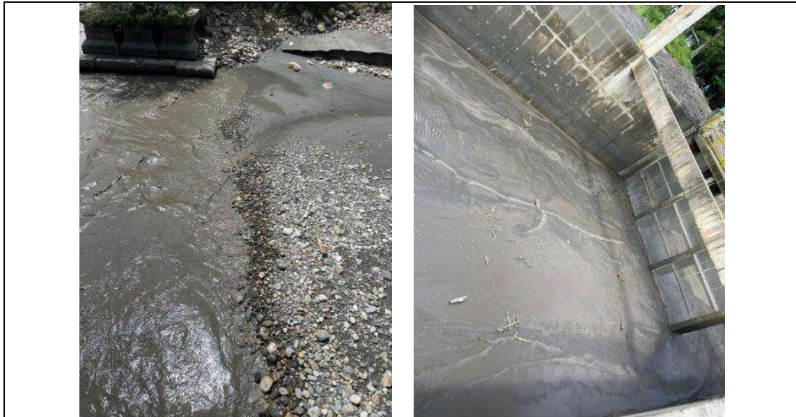
Ilustración 5 Sedimentación/colmatación de material en bocatoma el día 16 de junio/2024
