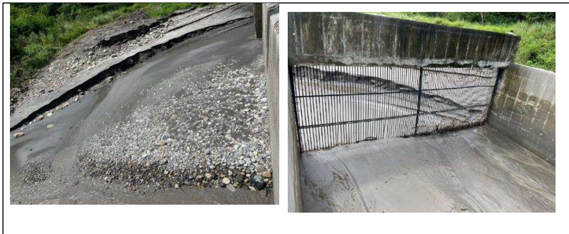
Ilustración 6 Sedimentación/colmatación de material en bocatoma el día 16 de junio/2024
