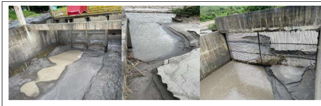
Ilustración 11 Acumulación de material en bocatoma en el mes de junio/2024
