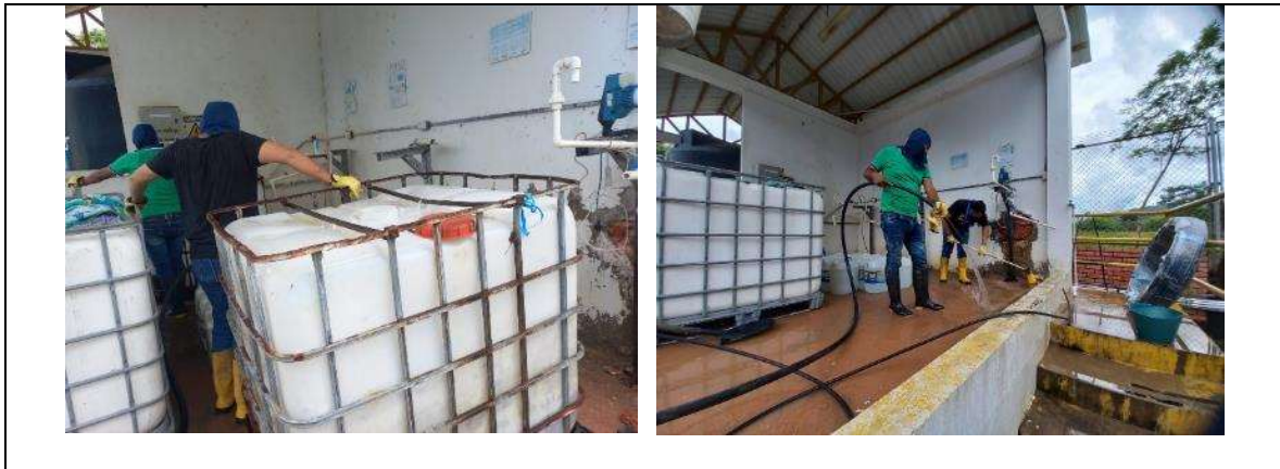
Ilustración 30 Mantenimiento de líneas de dosificación de químicos y limpieza de sala de dosificación. 26 de Junio/2024.
